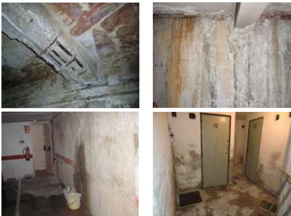
Fotos --Corrosión, degradación, filtraciones y humedades
